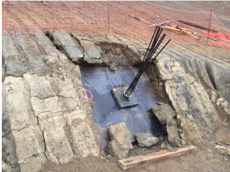
Fig. 2: Rotura del terreno en superficie.
